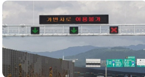
가변정보표지판 (Variable Message System)
